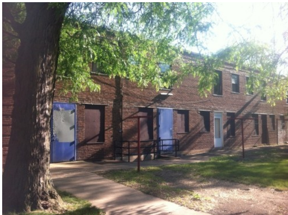
Figure 3. Logements murés et inoccupés à Lathrop Homes (2014)
